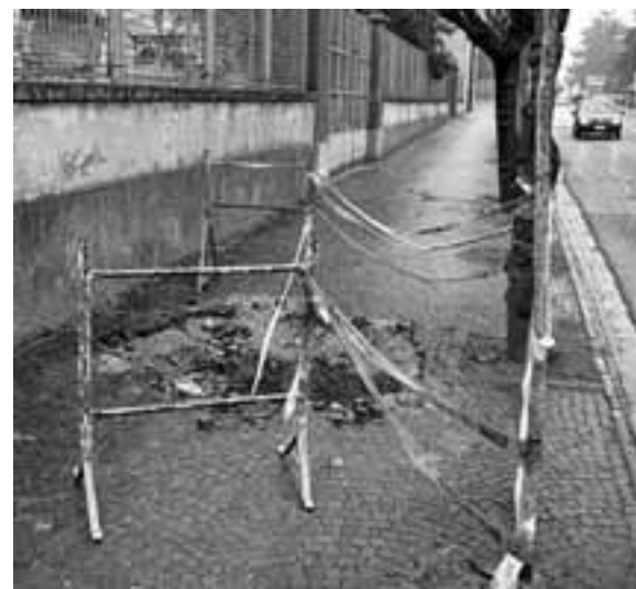
La buca che si è aperta nel marciapiede di corso Matteotti
